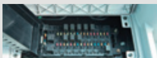
ヒューズボックス ラゲッジトレイ下に設置。ヒューズは細分化されトラブル発見が容易。
