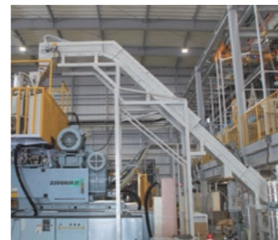
10 プラスチック材料搬送コンベヤ
