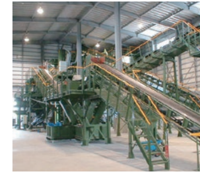
3 土壌改良設備
