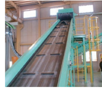
2 ブラウン管破砕物設備
