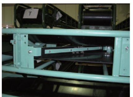
◎正逆運転 ナイフスクレーパーを取付 リターン側に取付
