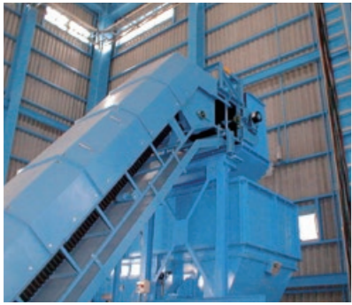
1 建設廃材設備
