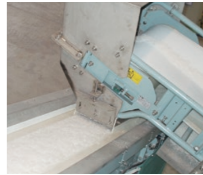
9 塩搬送コンベヤ
