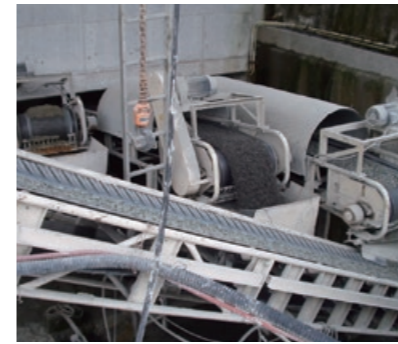
7 砂・砂利搬送コンベヤ
