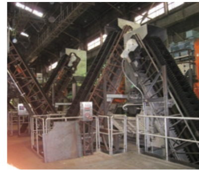
6 原料搬送設備 (急傾斜コンベヤ)
