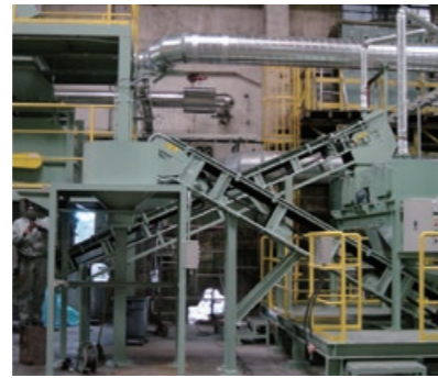
8 アルミ材搬送設備 (レギュラー・クライマーコンベヤ)
