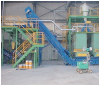
4 紙・廃プラスチック搬送設備
