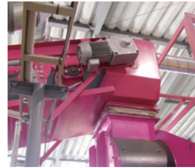
4 カレット搬送コンベヤ
