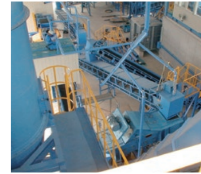
2 不燃物・可燃物搬送コンベヤ
