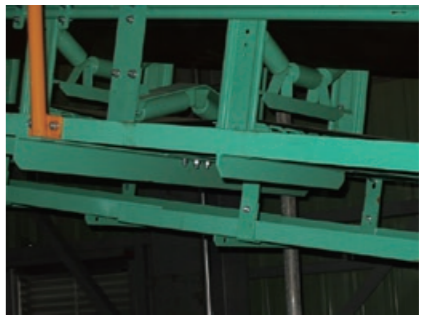
◎蛇行防止装置 リターン側ベルトの蛇行を防止する V型押さえローラ
