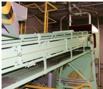
10 カレット搬送コンベヤ
