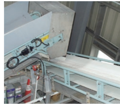
6 塩搬送コンベヤ
