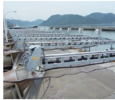
2 かき搬送コンベヤ
