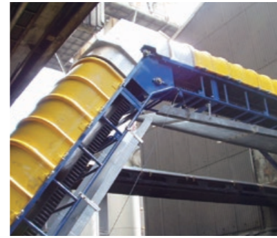
3 豆炭搬送コンベヤ
