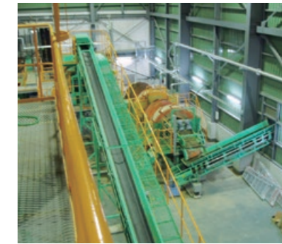
6 解泥土壌搬送設備
