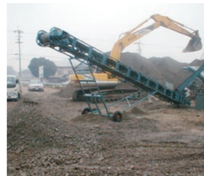
12 土砂搬送コンベヤ (油圧モータ)
