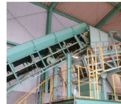
11 ゴミ搬送コンベヤ
