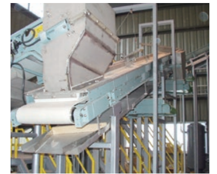
9 塩搬送コンベヤ
