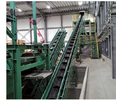
8 廃家電搬送設備
