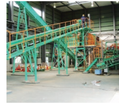
5 解泥土壌搬送設備
