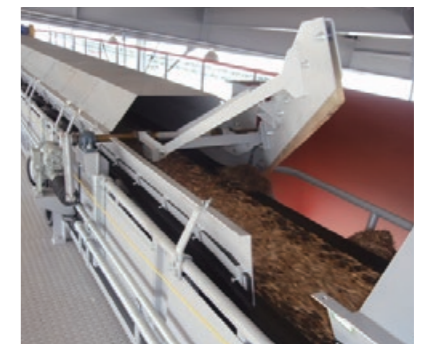
12 中間払出装置
